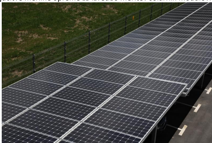
Slika 3: Sončna elektrarna na pokritem parkirišču Termoelektrarne Brestanica.
